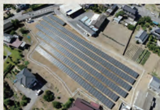
■ 邑楽郡邑楽町発電所
