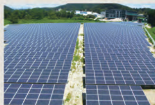
■ 日光市猪倉発電所
