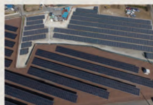
■ 館林市成島町発電所
