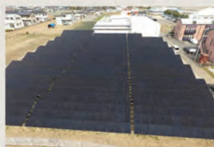
■ 富岡市神農原第2発電所
