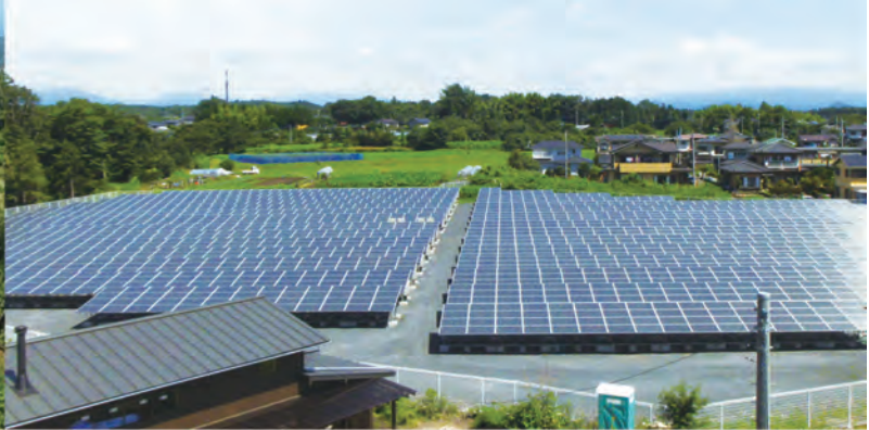
■ 日光市板橋発電所
