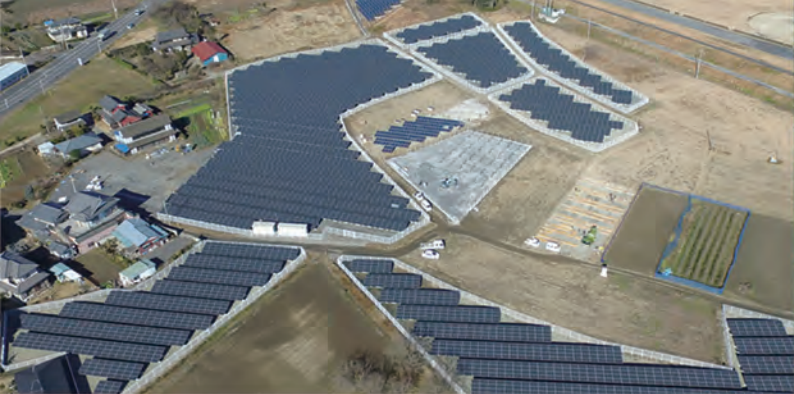
■ 太田市原宿町第2発電所
