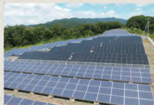
■ 足利市大前町発電所
