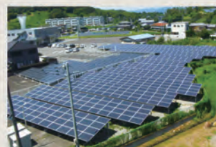
■ 太田市東金井町発電所
