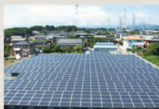
■ 太田市新田野井町発電所
