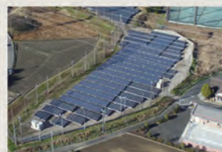
■ 足利市里矢場町発電所
