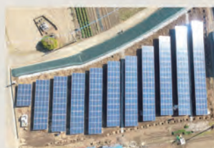
■ 太田市丸山町発電所
