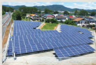
■ 太田市只上町発電所
